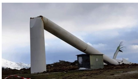
Εικόνα 7: Μία από τις ανεμογεννήτριες που κατέρρευσε από άνεμο στην Εύβοια (πηγή: tvstar.gr, 09-01-2020)
